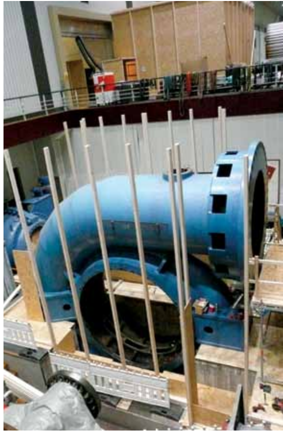
Kraftwerk Wehr: Turbinenspirale Maschine A10
