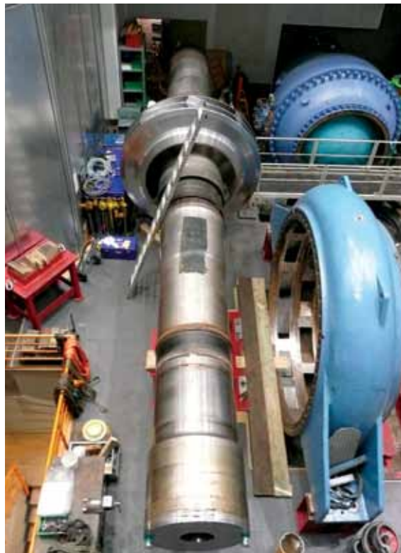
Kraftwerk Wehr: Pumpenwelle Maschine A10
