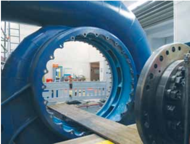
Kraftwerk Säcking: Turbinenspirale Maschine B7
