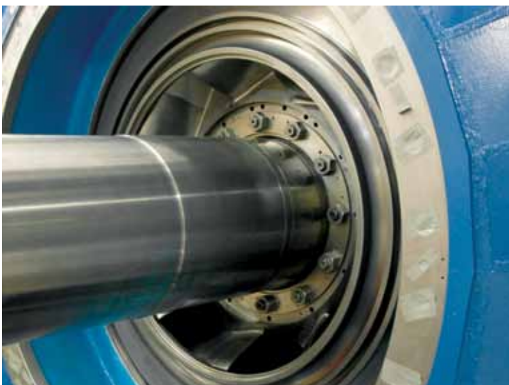
Kraftwerk Säcking: Pumpenspirale Maschine B7
