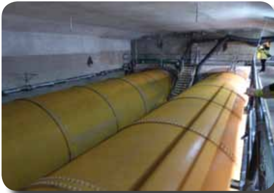
Kraftwerk Waldshut: Triebwasserleitungen im Hangrohrkeller
