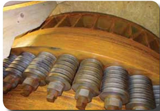
Kraftwerk Waldshut: Gelenkflansch an Turbine A5
