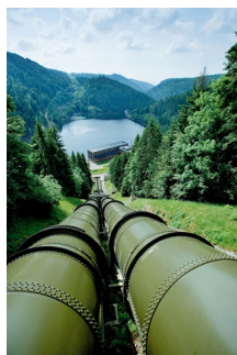
Bildunterschrift: Hangrohrleitungen des Kraftwerks Häusern
