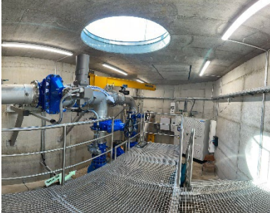
BU Anlage 2: Ein Blick in das Schau-Kraftwerk
