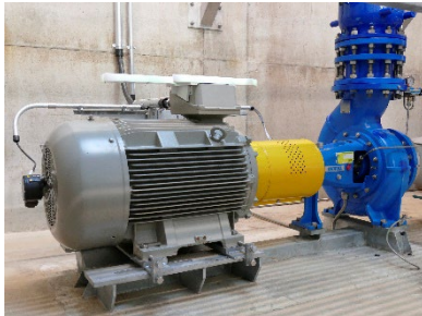
BU Anlage 3: Das Herzstück der Anlage ist eine rückwärtsdrehende Kreiselpumpe
