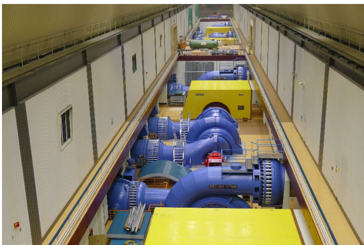
Bild 1: Blick in die Maschinenkaverne des Kraftwerks Wehr. Insgesamt vier Maschinensätze sorgen für die Stromerzeugung bzw. die Stromspeicherung.
